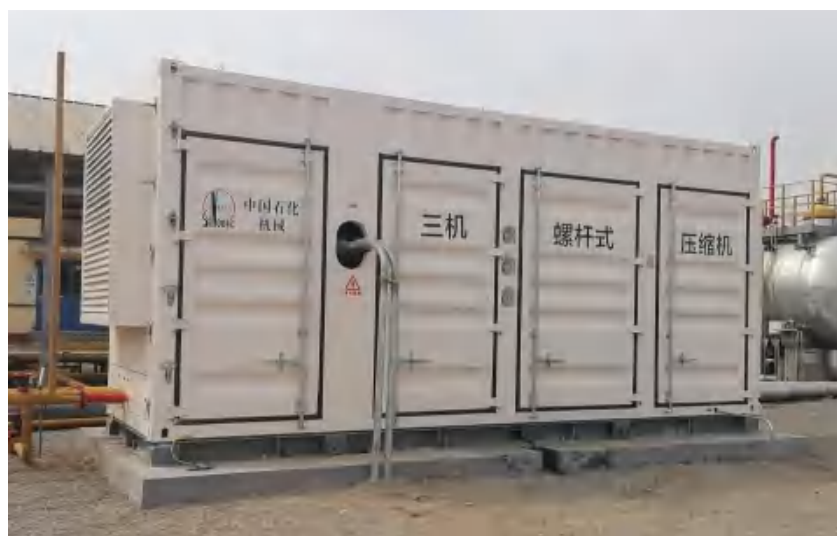
图 3.1-7 3号接转站新建天然气压缩机现场照片
