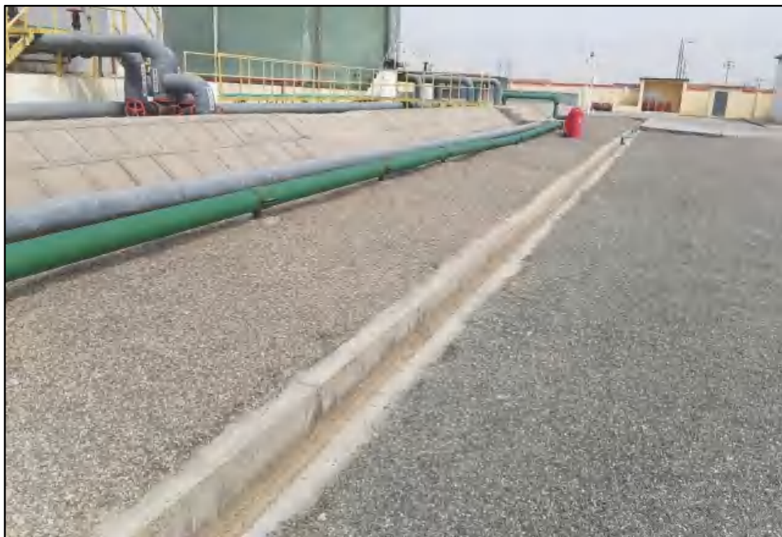
图 3.8-2 3号接转站油罐区防火堤雨水导排系统现场照片
